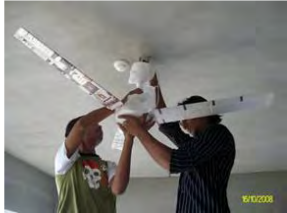
Notwendige Innenausstattung: Ventilatoren
